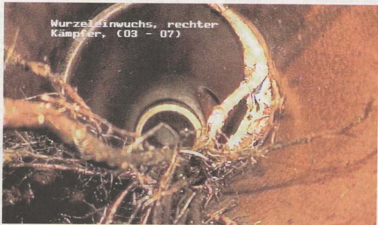
Ein Krefelder Kanalanschluss, zerstört vom Wurzelwerk eines Baumes. Und schon fließen Abwässer ins Erdreich.
